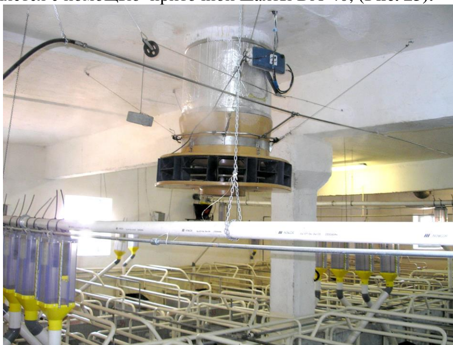
Рис.23. Приточная шахта DA-40
